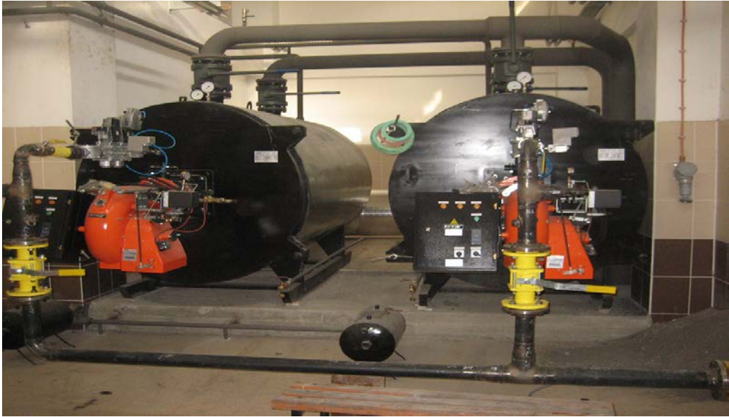
Ali Şevki Erek Yerleşkesi Isı Merkezi Tıp Fakültesi Morfoloji Binası Kalorifer Kazanları
