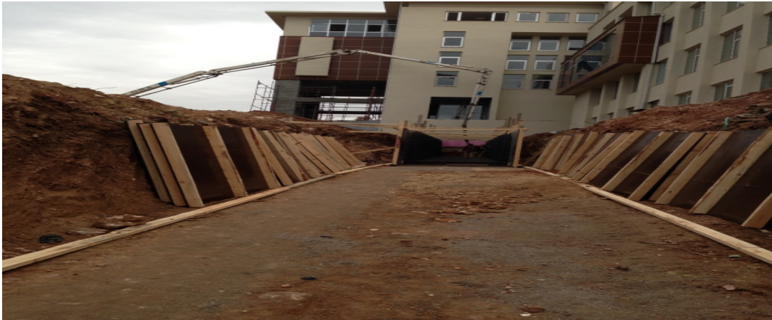
Eğitim Fakültesi Binası Galerisi Mekanik Tesisat İmatları
